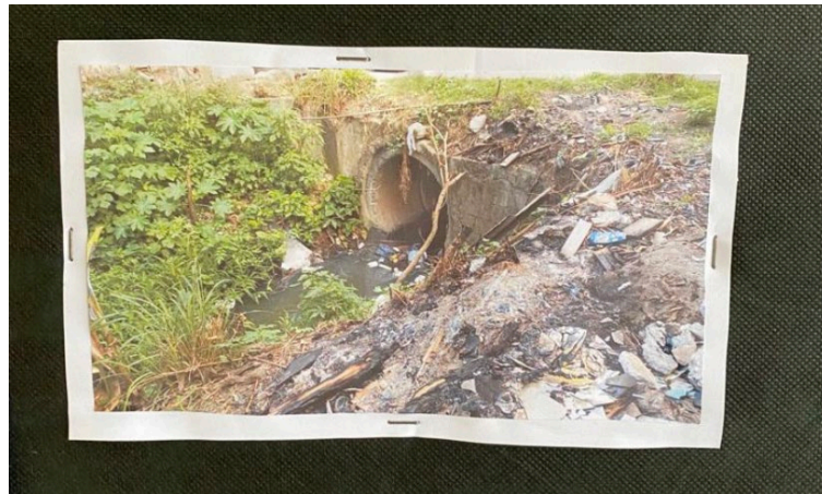
Figura 6: Esgoto a céu aberto
